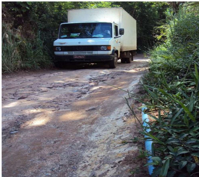
Cano mal enterrado, próximo ao Rufino Rocha.
