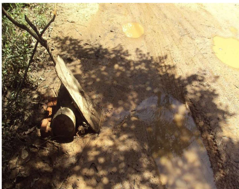
Proteção improvisada para vazamento de água (rompimento de cano) na estrada que vai até o Bomba.
