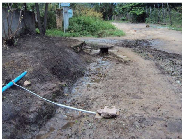
Ligações irregulares no cano principal que vem do Bomba, próximo ao Bar de Seu João.
